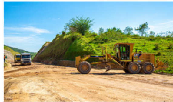
En las Unidades Funcionales 1 y 2 se hace intervención predial, ambiental y social para la construcción de la vía.
